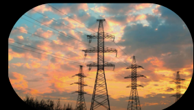
SATEL 69KV - LINHA TRANSMISSÃO
